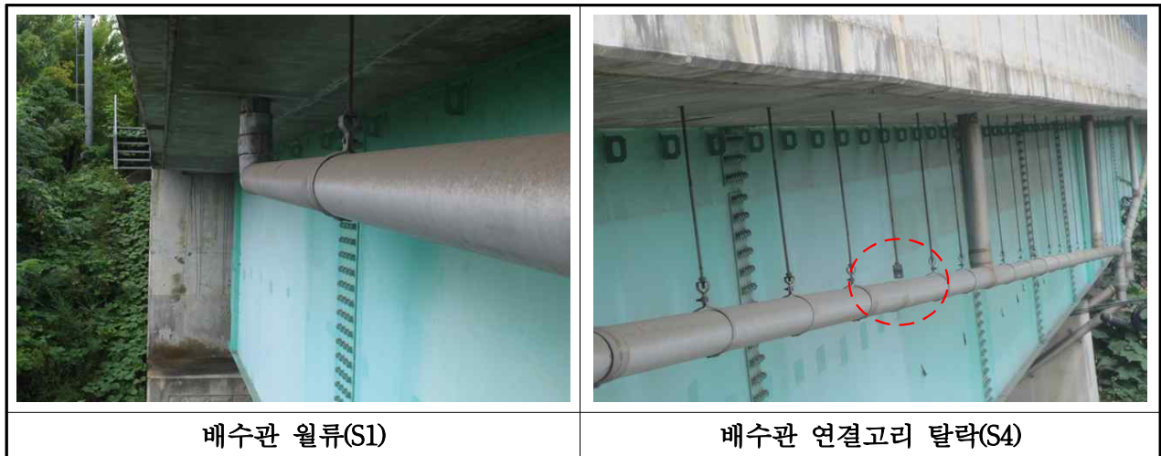
【사진 3.2.20】 배수시설 손상현황(대구)
