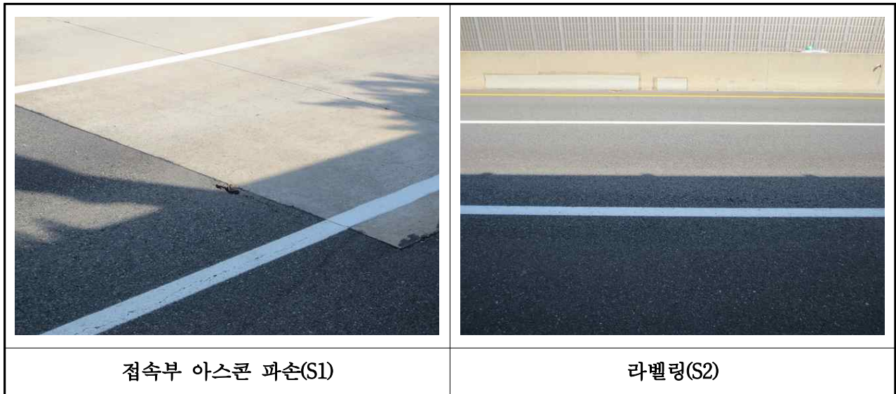
【사진 3.3.18】 교면포장 손상현황(부산)
