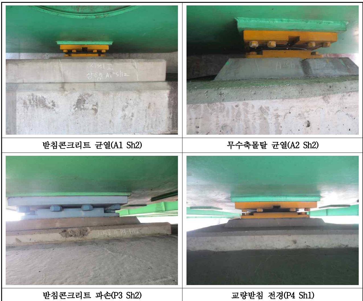
【사진 3.2.12】 교량받침 손상현황(대구)
