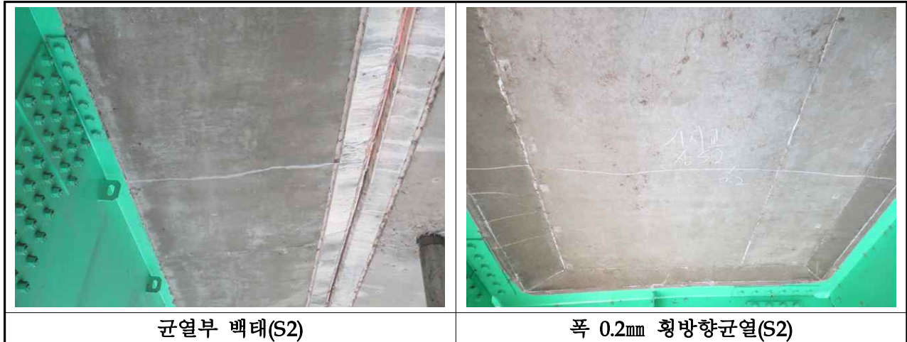
【사진 3.2.2】바닥판 손상현황(대구)
