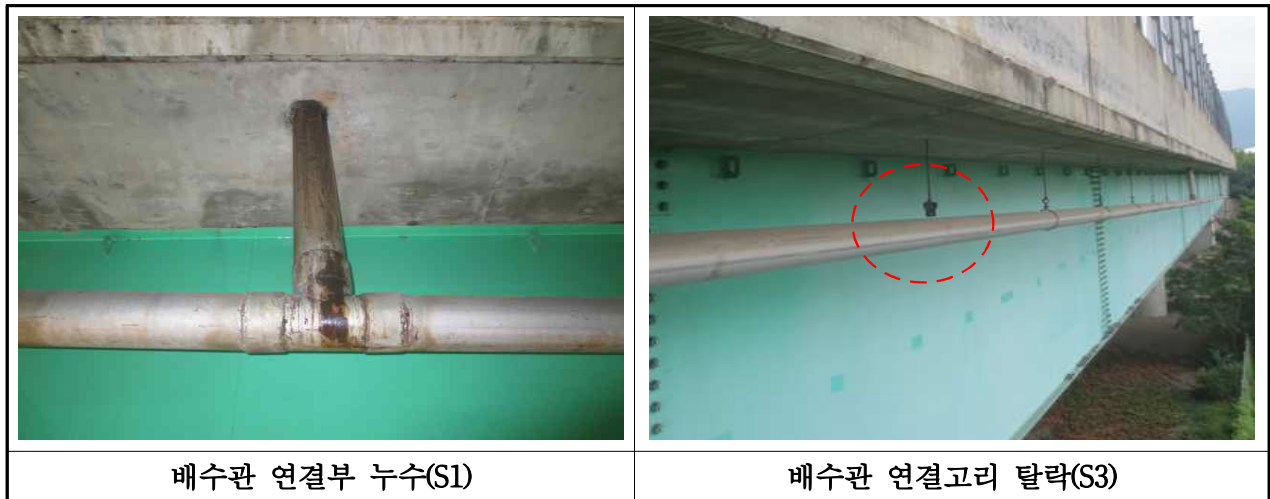
【사진 3.3.20】 배수시설 손상현황(부산)
