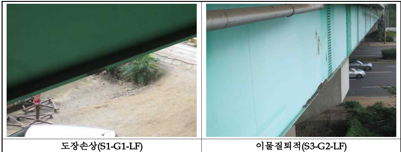
【사진 3.2.5】강박스 거더 외부 손상현황(대구)
