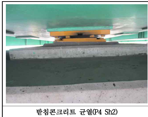
【사진 3.3.12】 교량받침 손상현황(대구)
