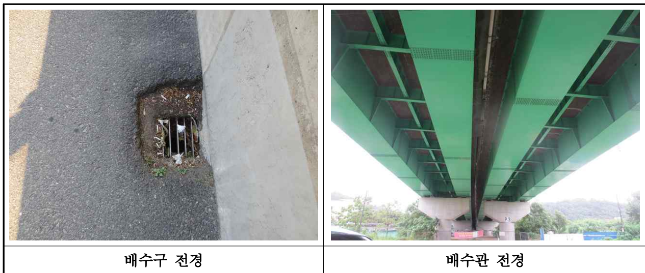
【사진 3.3.19】 배수구 및 배수관 전경(부산)
